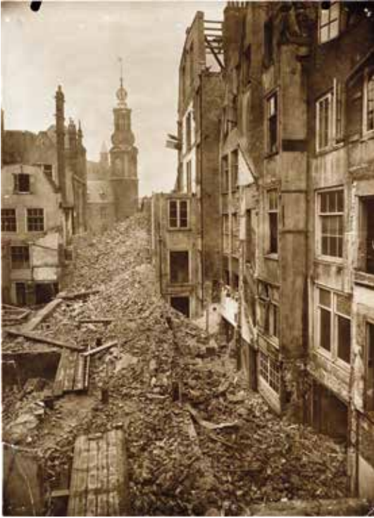
Vereenigde Fotobureaux N.V., Sloop van de huizen in de Vijzelstraat . Circa 1917 (foto: Stadsarchief Amsterdam, nummer OSIM00002005968)
